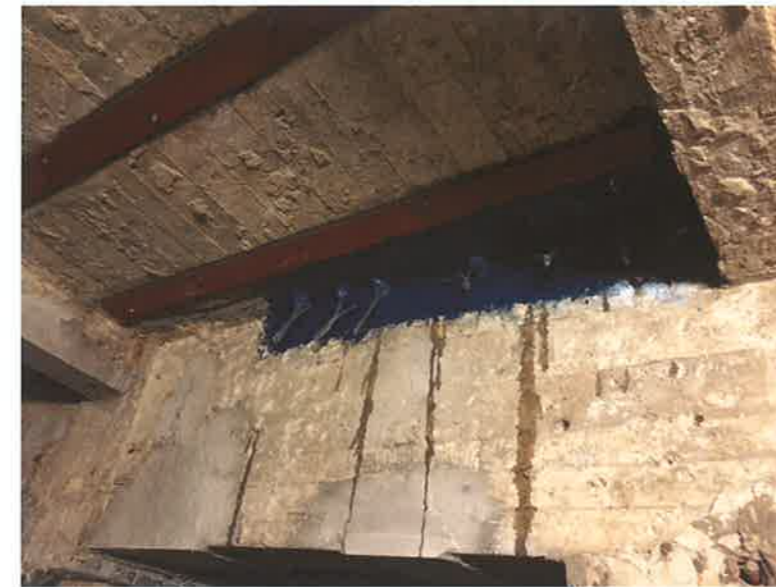
Fig. 7 Piscine de Saint-Josse-ten-Noode : injections à la résine époxy et renforcement par plats en acier de la dalle de fond de la cuve (2018 © AAC architecture).
